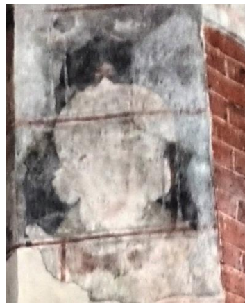
Kościół św. Mikołaja w Grudziądzu. Zaakcentowanie fug wątku grand appareil. Fot. M. Szajerka
